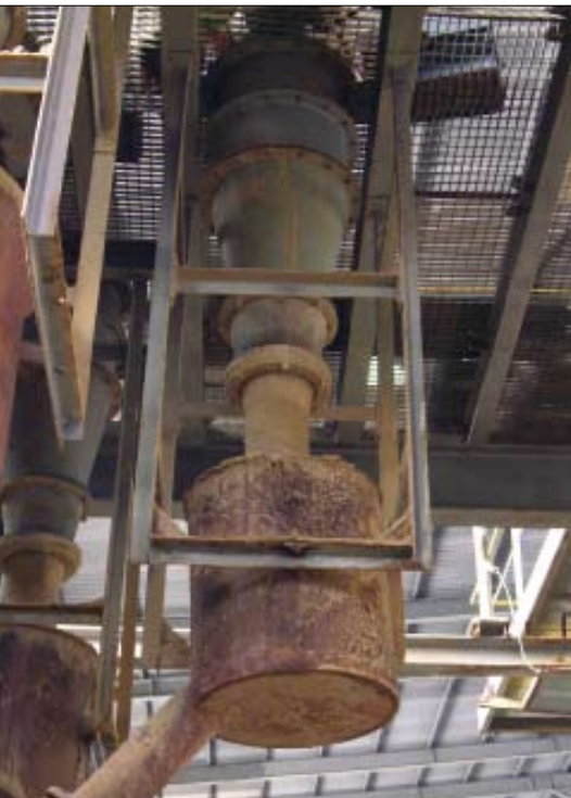
Unterlaufdüse im Einbauzustand.
